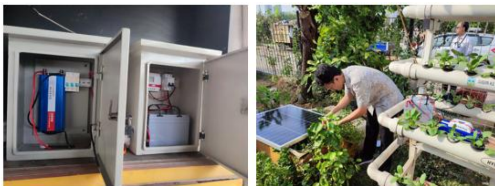
Gambar 3.1. Foto instalasi perangkat panel surya
