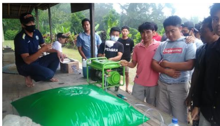
Gambar 3.2. Genset listrik berbahan bakar biogas bagi Kelompok Tani Bon Belok Kopi Desa Belok Sidan, Kecamatan Petang, Kabupaten Badung
